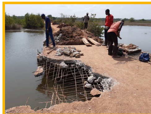
In dem Ort Bailor ist leider die Brücke stark beschädigt worden, so dass man den Ort derzeit nicht mit Fahrzeugen erreichen kann.
